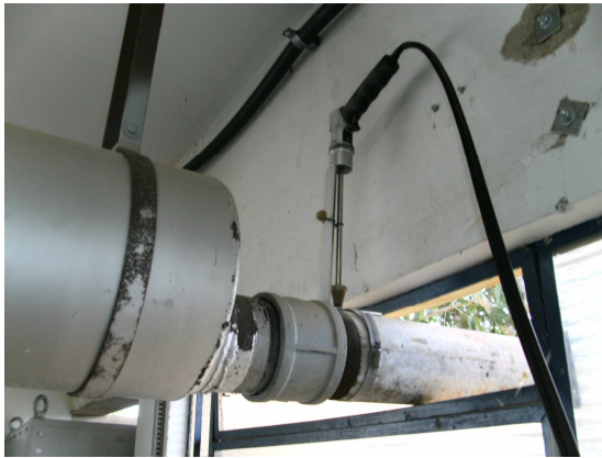
Figura 11 - Sonda do analisador de gases instalada
